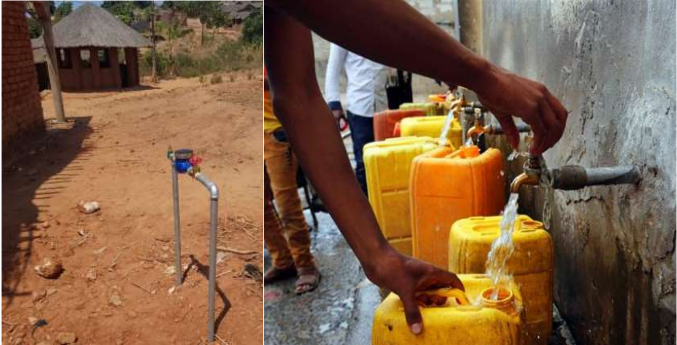
FIGURA 20: TORNEIRA DE QUINTAL MUNIDA DE CONTADOR E VÁLVULA DE CORTE (À ESQUERDA) E FONTANÁRIO (À DIREITA) DO NOVO SISTEMA DE ABASTECIMENTO DE ÁGUA DE MARRUPA
